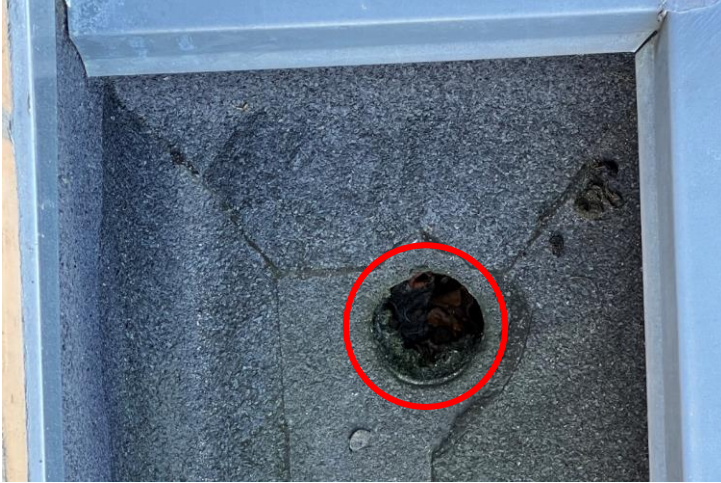
Tagedløb er umiddelbart tilstoppet.
